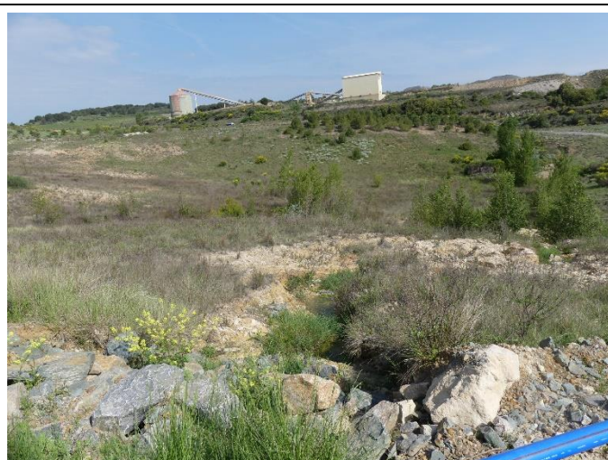
Illustration 16 : Merlon de protection dégradé en amont de la mare B2
