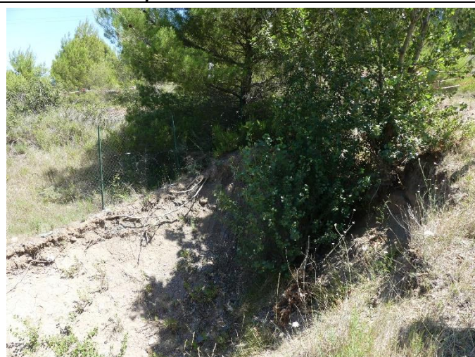
Illustration 48 : Fossé drainant Nord-Ouest, fortement raviné
