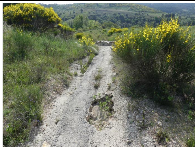
Illustration 18 : Portion de caniveau dégradée le long de la RD111
