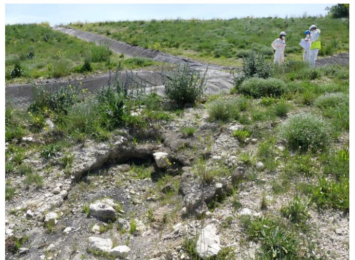
Illustration 6 : Début d'érosion des sols sur le flanc Est du site
