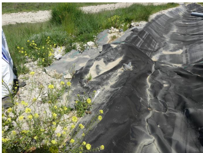
Illustration 7 : Mise à nu de la géomembrane par érosion
