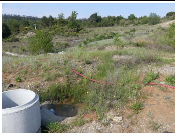
Illustration 36 : Avaloir bétonné de la source Arsine
