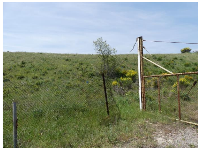
Illustration 52 : Clôture déteriorée au droit de l'ancien portail
