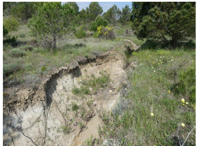
Illustration 20 : Caniveau d'amenée des eaux à la mare RM2 très raviné
