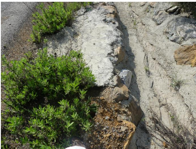
Illustration 21 : Légère dégradation et début de sous-cavage du réseau de gestion pluviale à proximité du portail d'accès au Champ Magné
